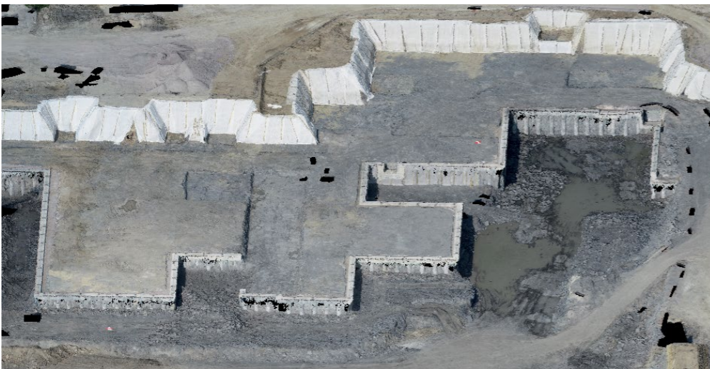
Ausschnitt bereinigter Punktwolken, Projekt: Erdbauarbeiten Neubau der Klinik am Eppert, Göppingen (© LEONHARD WEISS GmbH & Co. KG)
